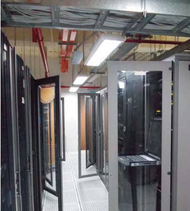
Lampu T6 di setiap koridor server farm
