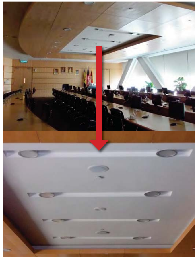
Bilik Mesyuarat Tanjung yang telah digantikan lampu LED
