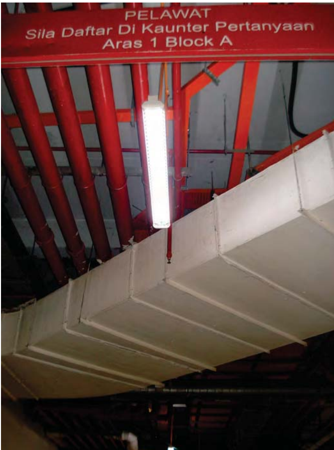
Lampu T6 sebagai alternatif kepada lampu LED memandangkan kosnya lebih rendah
