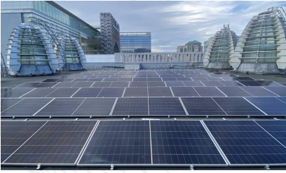
Solar fotovolta (PV) di Kompleks Perbadanan Putrajaya, Presint 3
