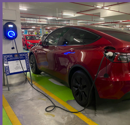
Charging plug di Blok F6, Kompleks F, Presint 1
