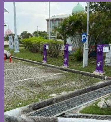
Stesen pengecas (AC - 7kW) di Laman Perdana, Presint 1
