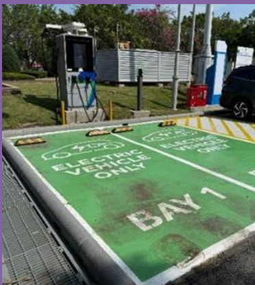
Stesen pengecas (DC - 120kW) di Laman Perdana, Presint 1.
