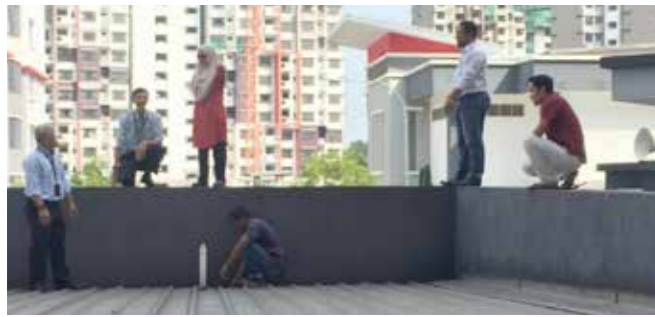
Kebocoran Bumbung di antara tingkat
